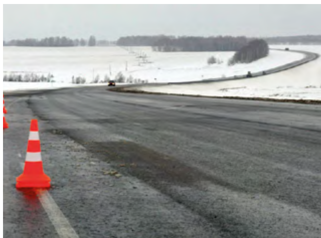
Участок дороги Павловск-Новосибирск
