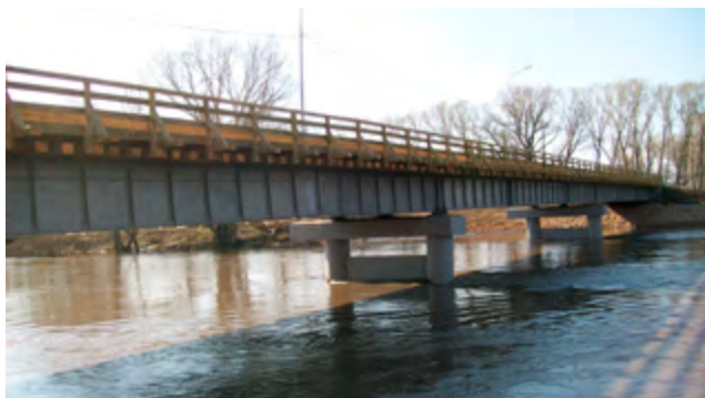
Новый мост через р. Алей в с. Устьянка, построенный при поддержке депутатов краевого парламента С.А. Бенслера и А.А. Романенко
